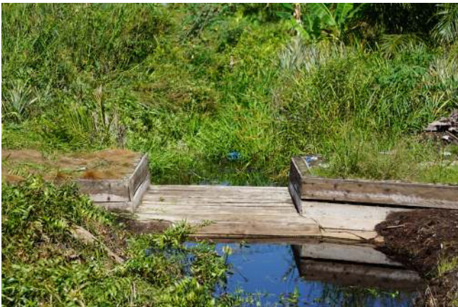
Foto: Sekat kanal yang penuh semak dan air yang tidak mengalir. Koordinat N: 1 59'9.712" E: 100 35' 18.733"
