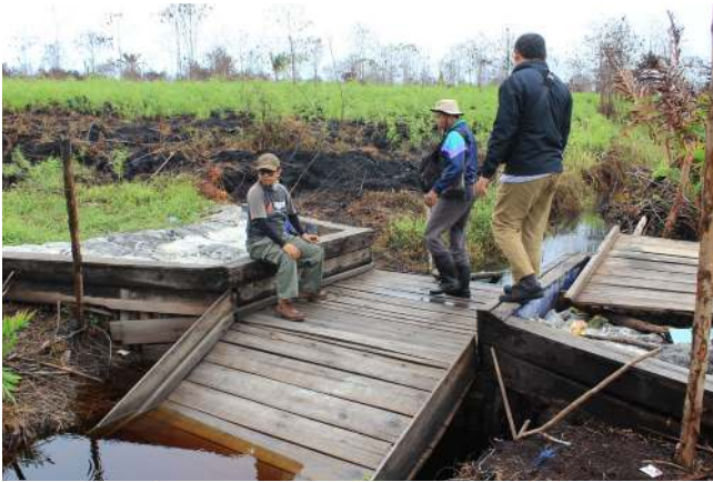
Foto: Kondisi sekat kanal di dekat lokasi terbakar di Lukun. Koordinat lokasi sekat kanal (sesuai keterangan pada papan penanda PIPG): N 00 53,730' E 102 47,715' (N 00 53' 43,86" E 102 47' 42,94")
