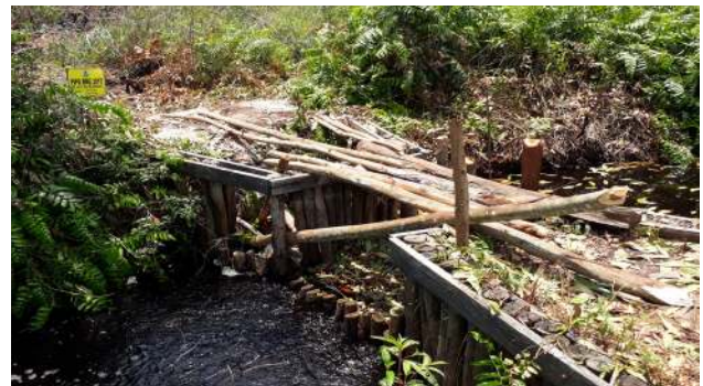
Foto: Sekat kanal kondisi rusak parah. Sekat kanal kondisi bocor. Koordinat N 01 38'49" dan E 101 30'48"
