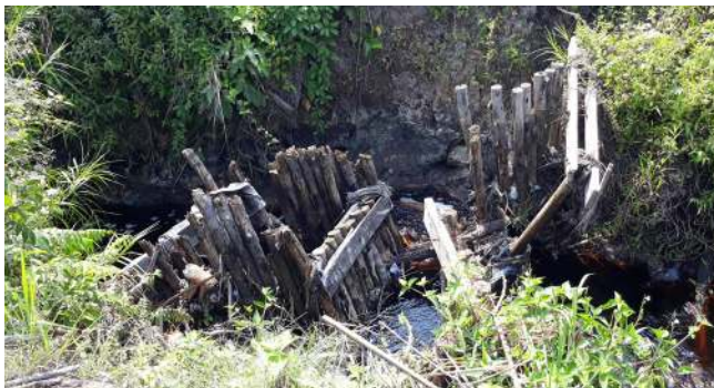
Foto: Sekat kanal kondisi rusak parah. Sekat kanal kondisi bocor. Koordinat N 01 38'49" dan E 101 30'48"
