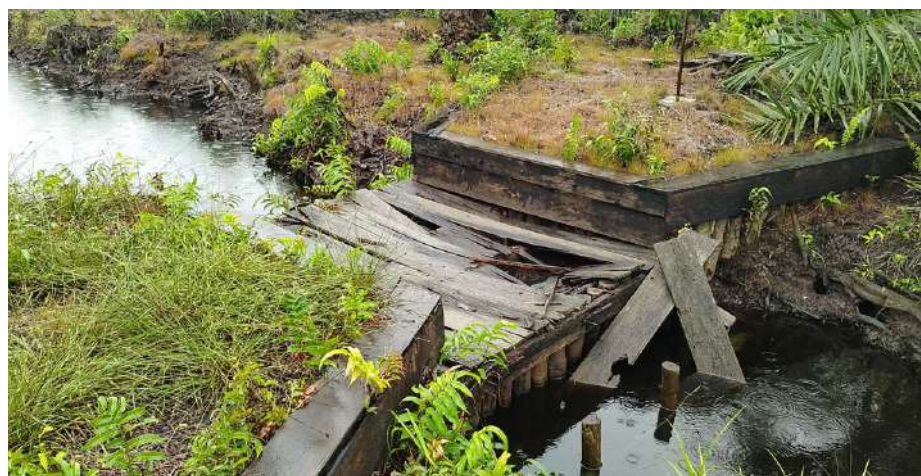
Sekat kanal BRGM berkondisi rusak yang ditemukan pada (kiri) KHG Pulau Rupat dan ↑ (kanan) KHG Sungai Rokan–Sungai Siak Kecil, Provinsi Riau ©Pantau Gambut 2024
